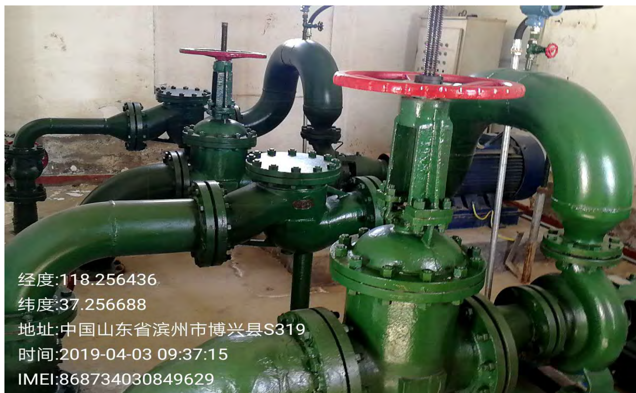
2 台污水提升泵
