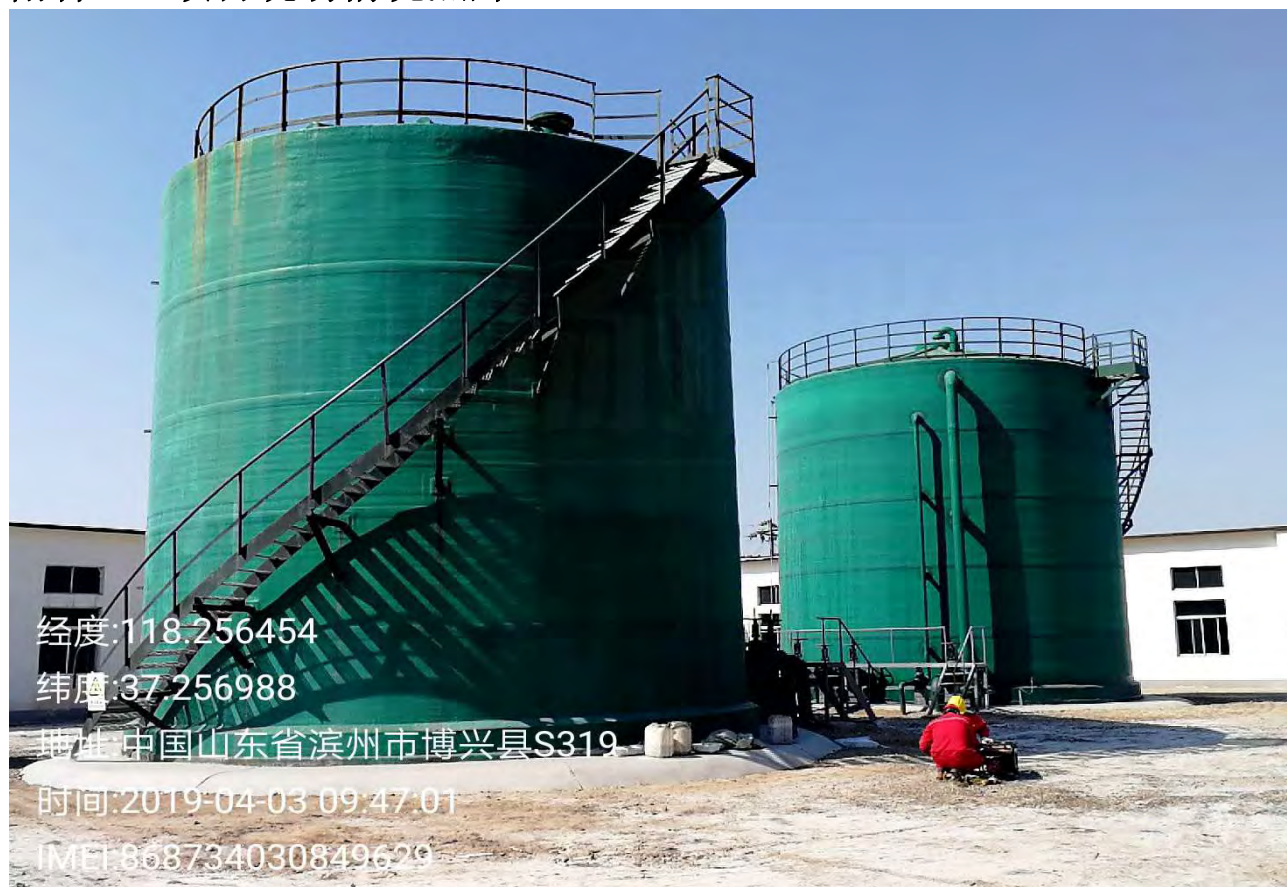
2 座 500m 3 注水罐
